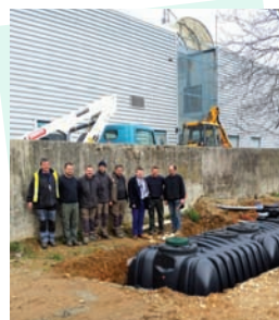
Cuve installée au CATEM en 2017 d'une capacité de 10 000 litres
